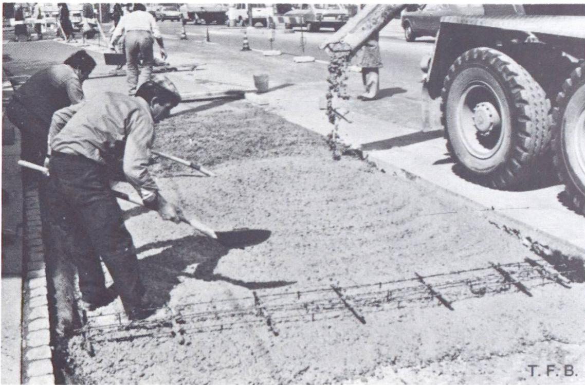
Fig. 3 Mise en œuvre de béton liquide sur un petit chantier. Revêtement pour une halte de bus.
