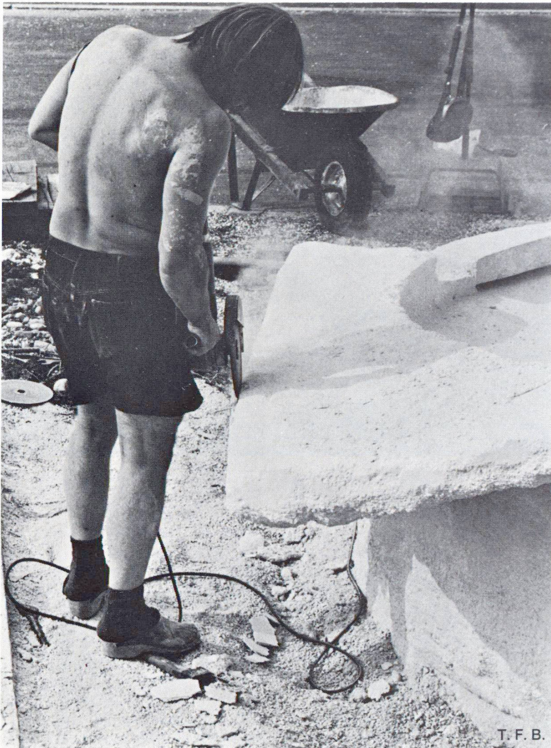
Fig. 5 Travaux de finissage à la meule. Les surfaces et les arêtes meulées se distinguent bien de celles qui sont restées brutes.
