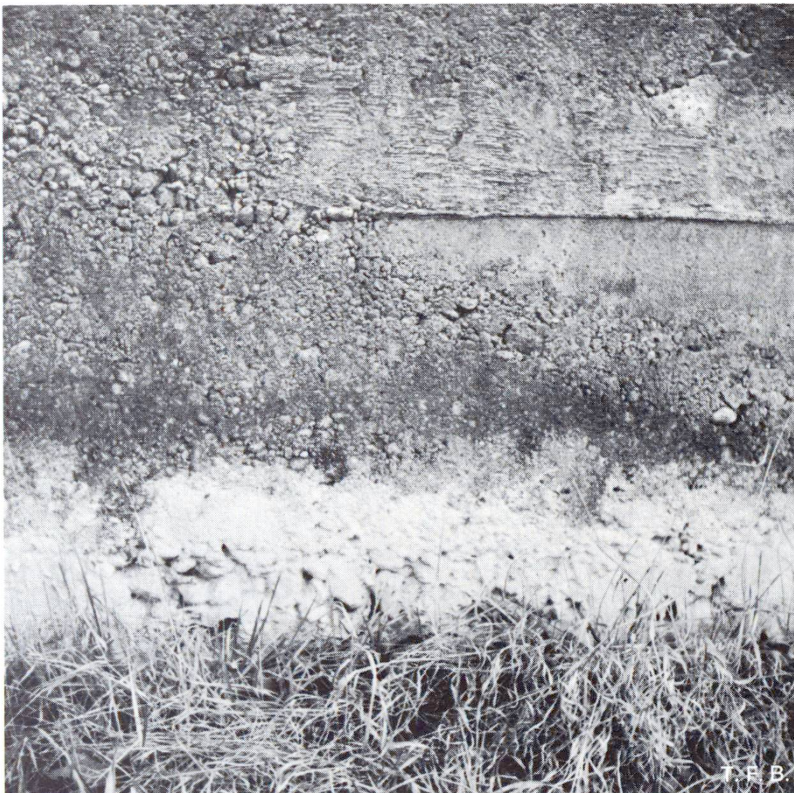
Fig. 6 Dans un béton à dosage trop faible, il est fréquent de constater des nids de gravier et des efflorescences.
