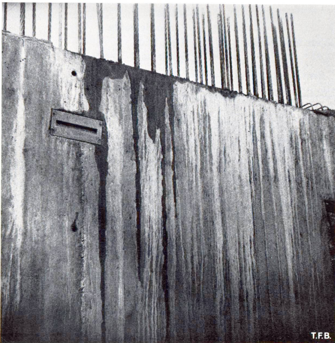
Fig. 8 Couronnement de mur non couvert
