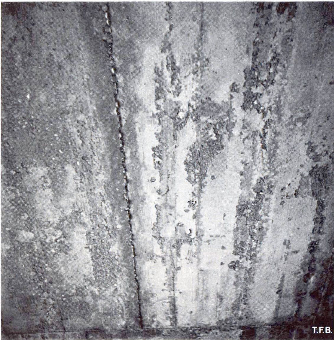
Fig. 5 Cisaillement à la surface inférieure d'un «béton jeune» dû à la flexion ou à des ébranlements du coffrage.
