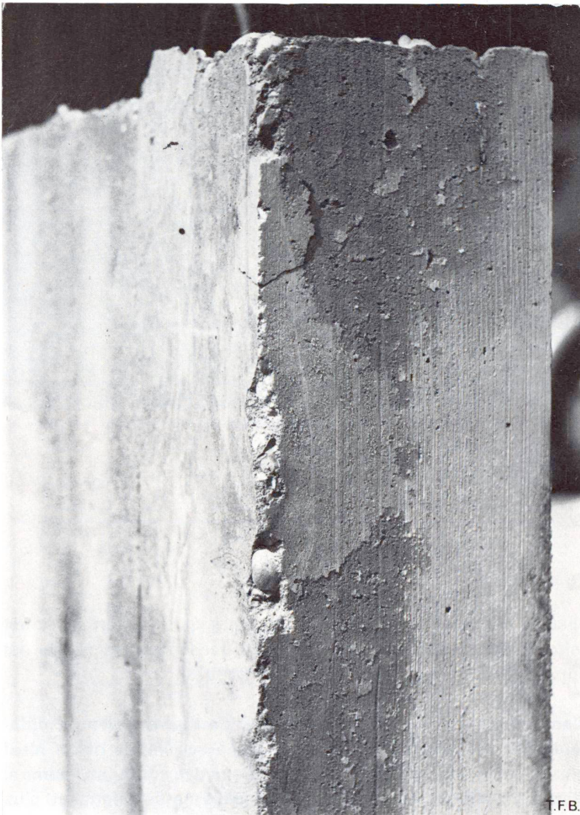
Fig. 4 Rupture d'une arête et décollements de la pellicule de ciment dans un «béton jeune», dus au gonflement d'un coffrage en bois.
