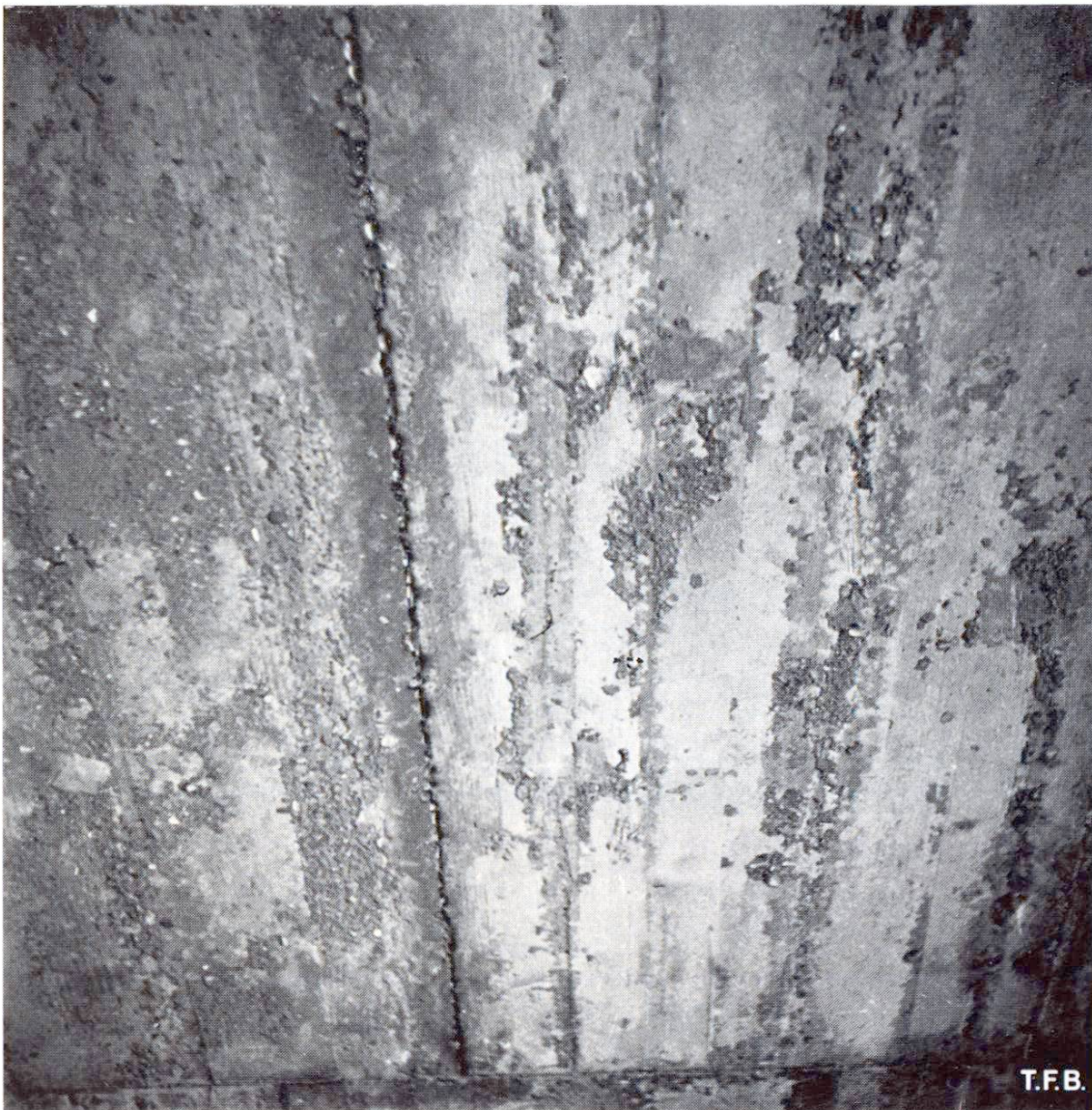
Fig. 5 Cisaillement à la surface inférieure d'un «béton jeune» dû à la flexion ou à des ébranlements du coffrage.
