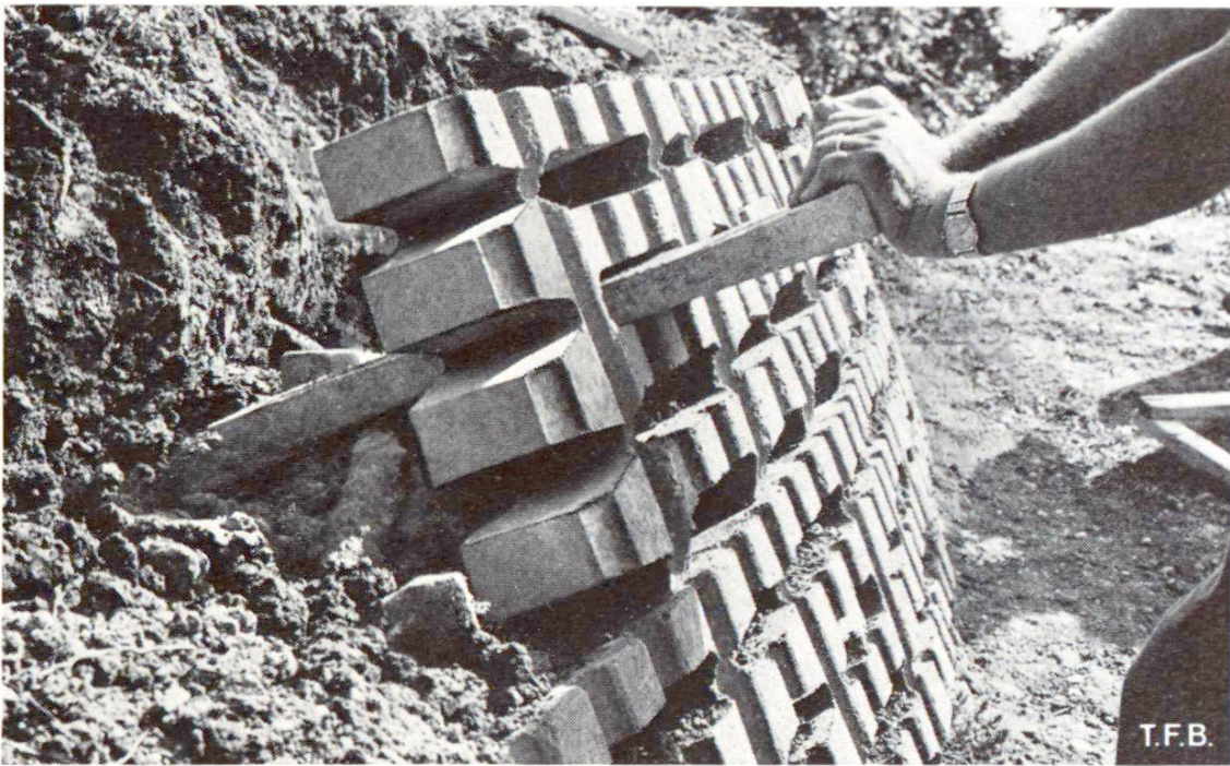
Fig. 4 Consolidation d'un talus. Dans les plus grands évidements des pavés-grille, on peut glisser des dalles de béton formant ancrage du revêtement.
