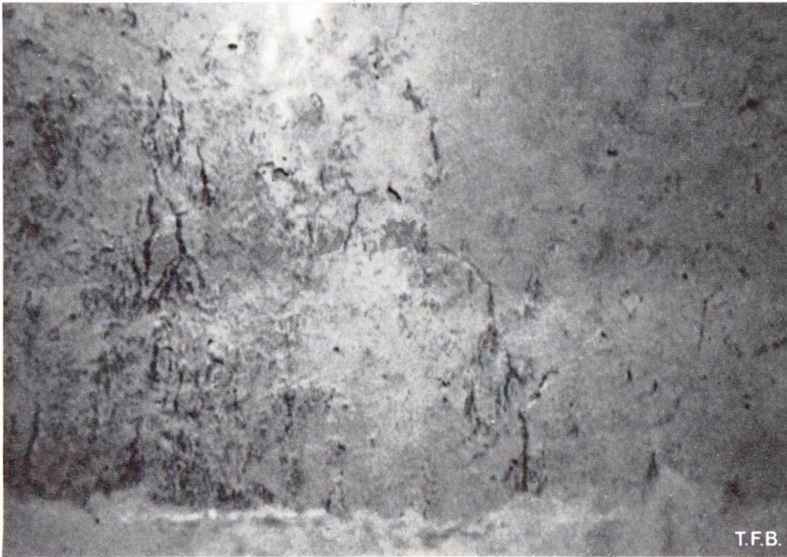
Fig. 8 Ségrégation d'eau dans un nid de gravier colmaté près d'un joint de bétonnage. La consistance du béton était certainement trop fluide.
