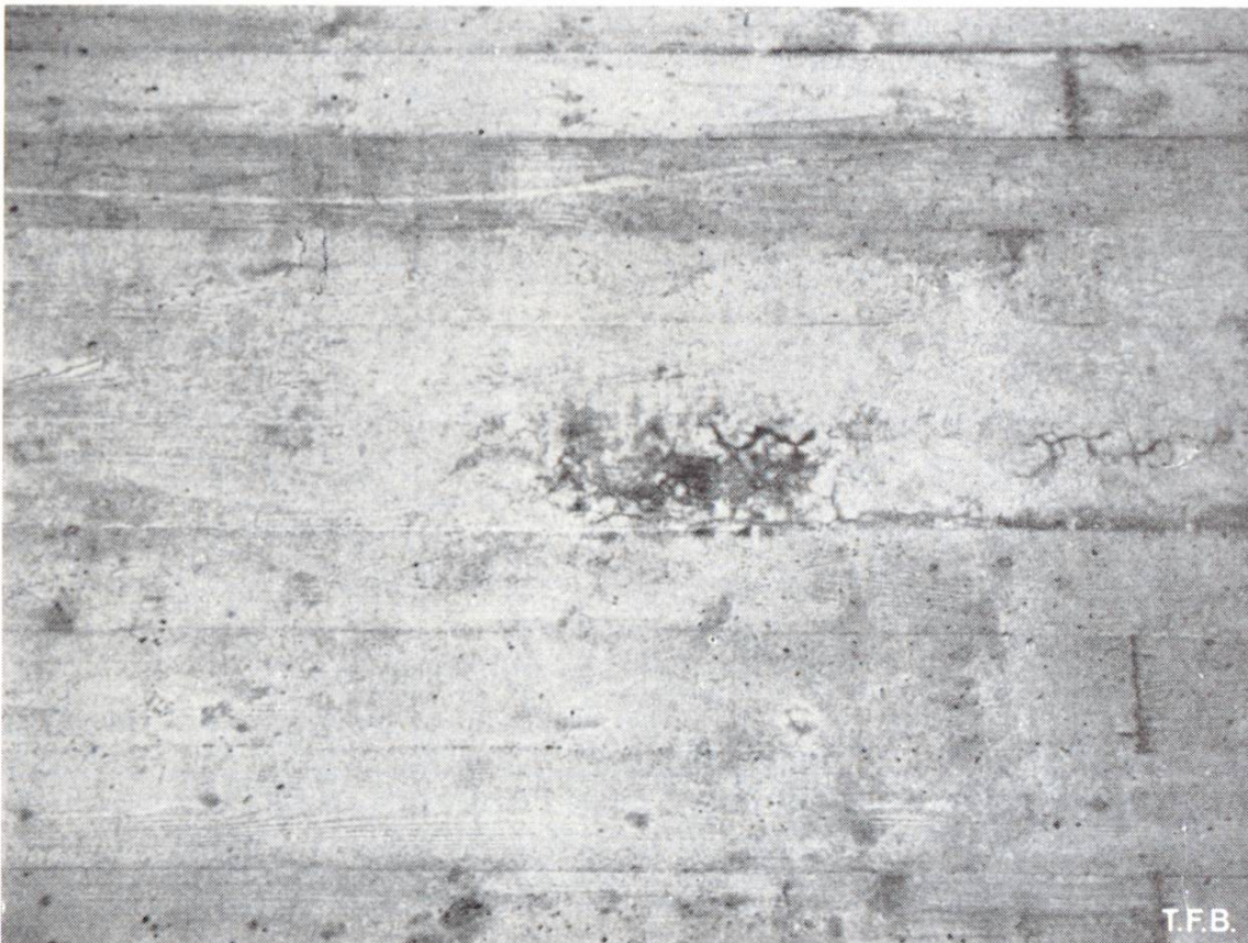
Fig. 5 Petit nid de gravier complètement colmaté. On ne voit qu'une teinte plus marquée.
