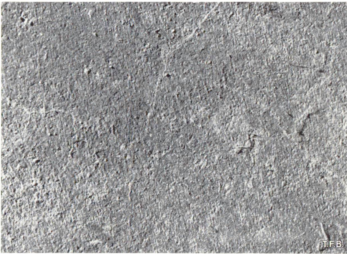
Fig. 2 Très fines fissures en réseau dans un béton sortant de coffrages lisses. Il s'agit d'un agrandissement, la largeur de la photo représente 1 cm. Espacement des fissures 5–10 mm, ouverture 0,005–0,01 mm, profondeur 0,5–1,0 mm.
