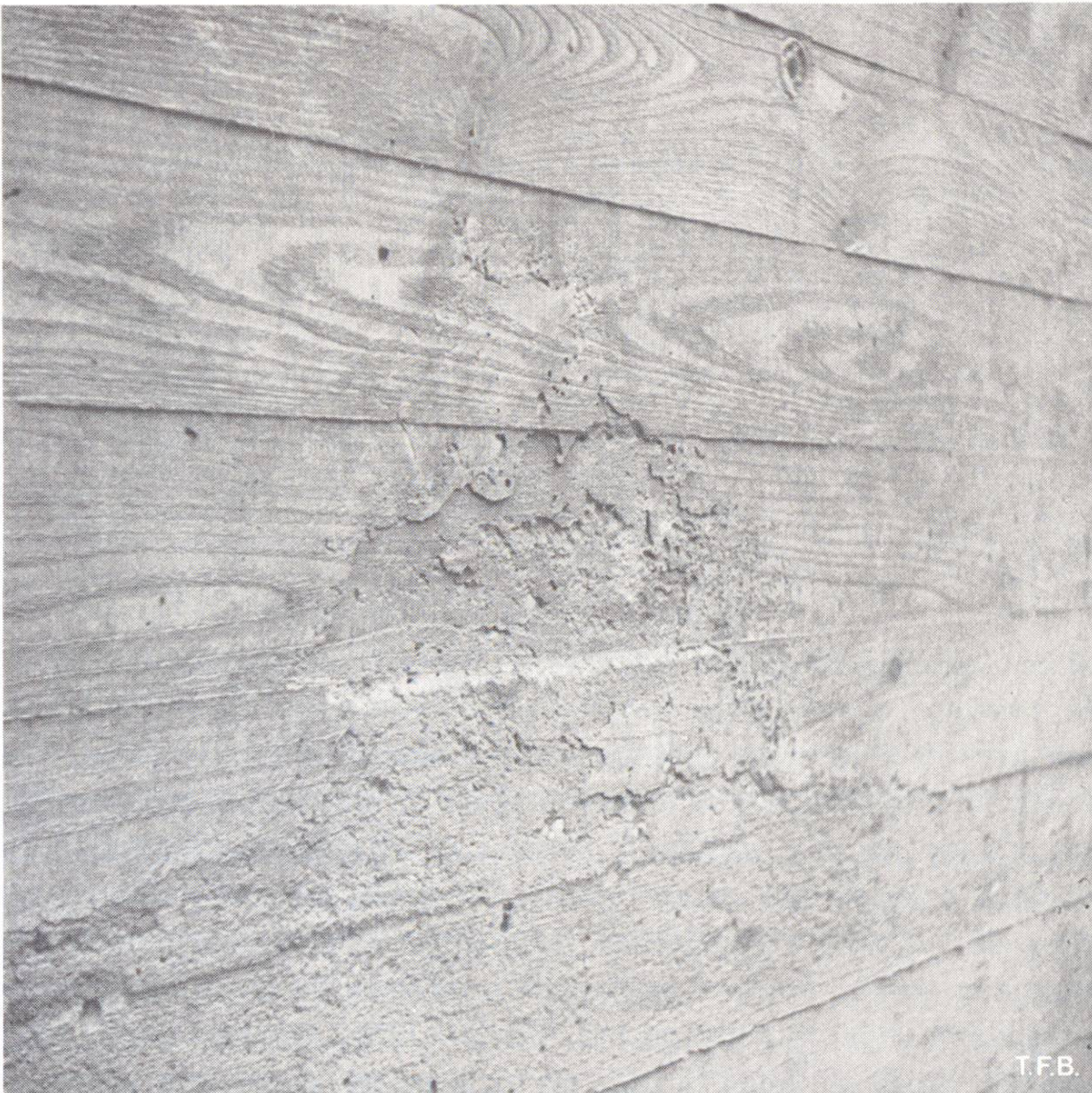
Fig. 5 Décollements étendus de la pellicule de ciment dus à des déplacements du coffrage lors de la mise en place et de la vibration de la couche suivante (coffrage mal étayé, éventuellement première couche mal vibrée).
