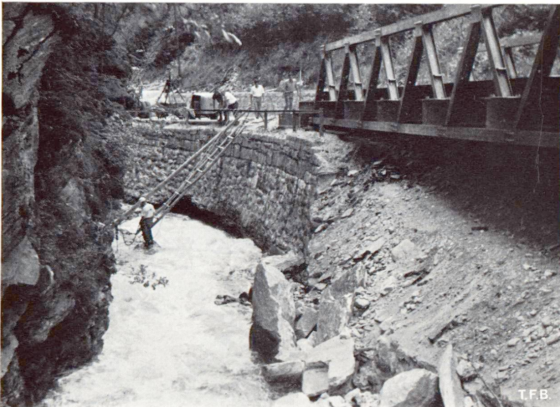
Fig. 3 Mur de soutènement dont la fondation a été affouillée.
