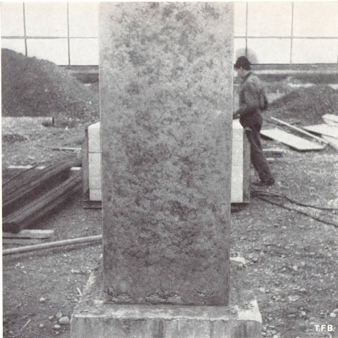
Fig. 5 Traces laissées par de faibles pertes de lait de ciment et par le tassement du béton le long du coffrage.
