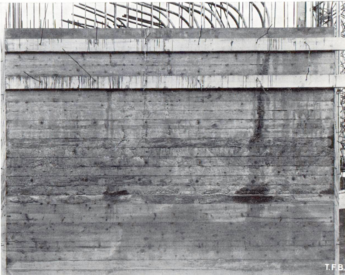
Fig. 2 Une paroi de béton apparent construite en béton coulé. Dans la moitié inférieure un joint de reprise du type 3 avec couche supérieure mal serrée. Au milieu de la hauteur, un joint type 1 avec traces bien visibles de ségrégation de l'eau (traînées verticales avec diverses teintes de gris). Surfaces presque noires dues à la pénétration d'eau de pluie dans un béton très poreux.
