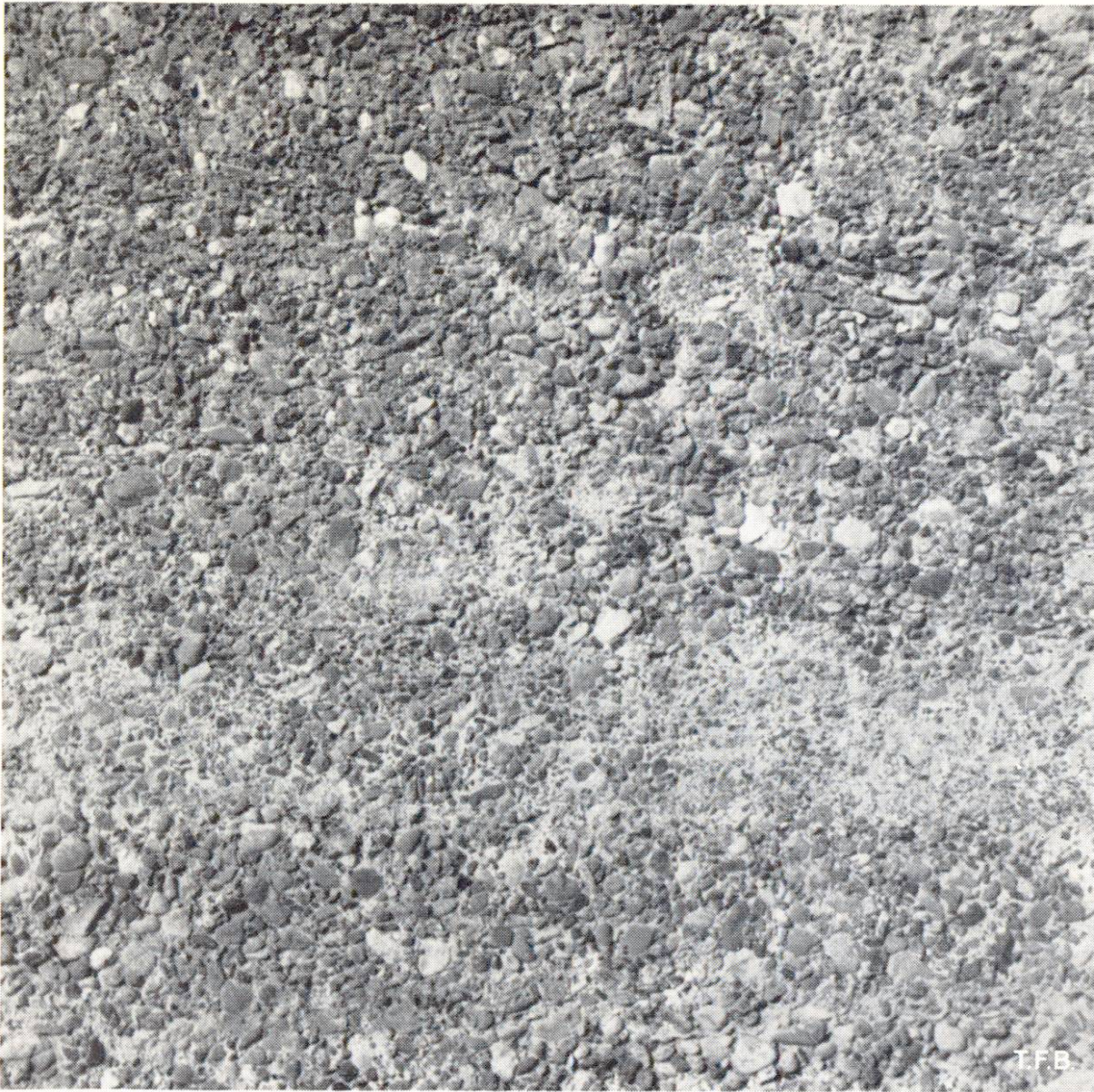
Fig. 2 Béton lavé. Gravier rond ordinaire de 30 mm. Légère ségrégation par endroits.
