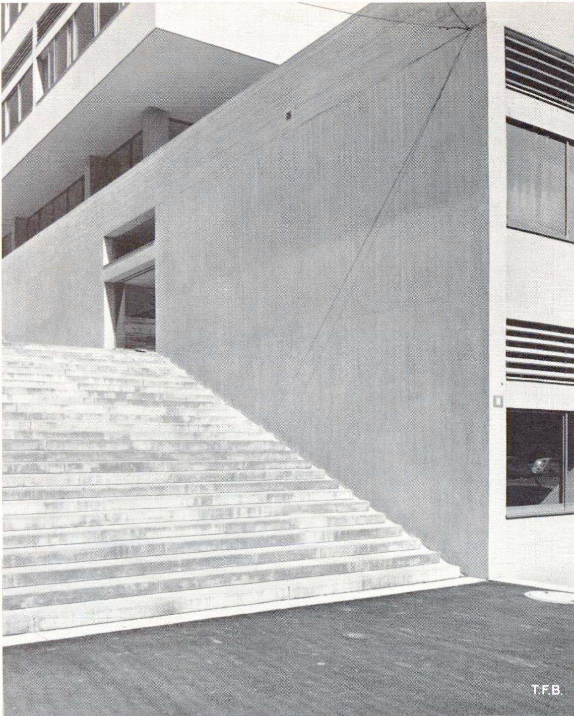
Fig. 7 Les grandes surfaces du béton apparent posent des exigences particulièrement sévères en ce qui concerne leur régularité. Les plus petits écarts dans les proportions du mélange, dans son homogénéité ou sa teneur en eau peuvent provoquer des différences de teinte. Sur cette photo, la partie supérieure paraît ne pas avoir atteint le même degré de durcissement que la partie inférieure. La différence de teinte devrait donc disparaître avec le temps
