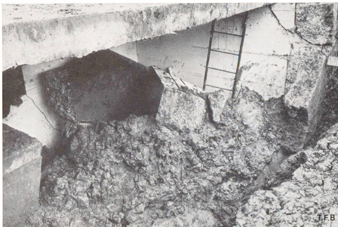
Fig. 2a Effet: paroi complètement démolie
