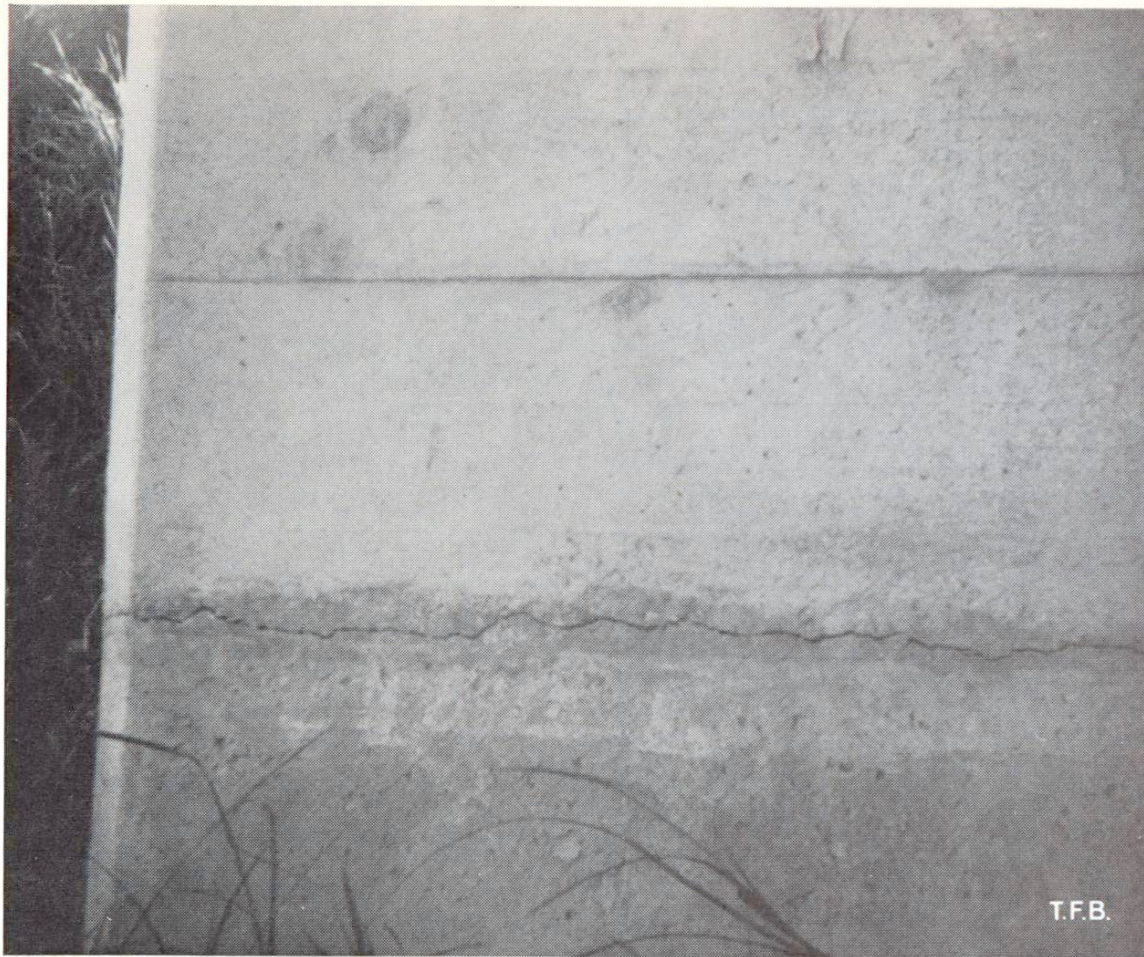
Fig. 3 Large fissure de tassement le long d'un joint de travail dans un pilier. On remarque les traces d'une très lente cicatrisation facilitée par l'humidité montant du sol
