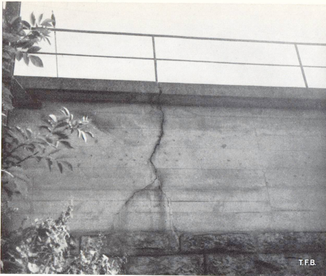
Fig. 4 Cette fissure de tassement dans un pont est trop large pour qu'on puisse attendre sa cicatrisation
