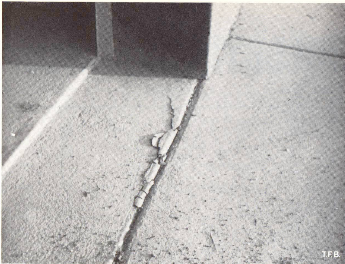
Fig. 1 Rupture d'une arête le long d'un joint mal nettoyé et de plus, mouillé avec excès lors de son façonnage
