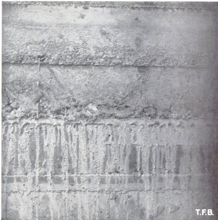
Fig. 3 Aux joints de reprise, on a aussi un risque de perte de liant, notamment si, comme dans l'exemple de cette figure, le nouveau coffrage n'est pas bien appliqué sur l'ancien béton. Comme le joint de reprise est déjà par lui-même un point faible de la construction, des petites erreurs de ce genre doivent être évitées
