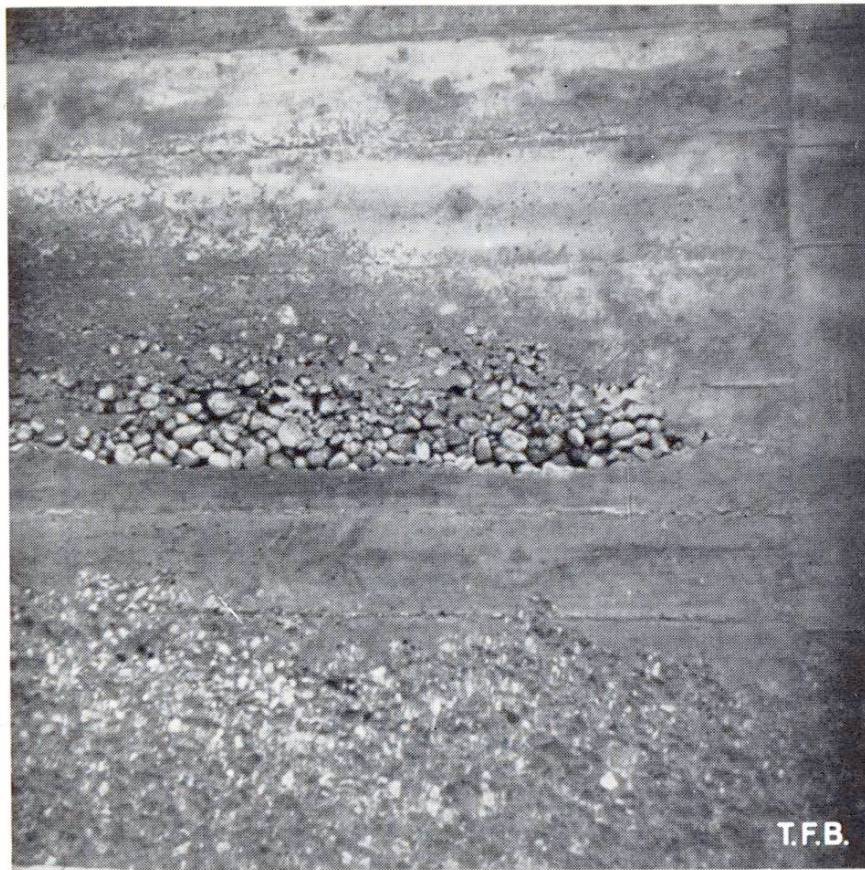
Fig. 4 Pourquoi ce nid de gravier? Parce que le béton a été déversé directement dans le coffrage relativement haut, à partir de la benne de transport. On aurait pu l'éviter en déchargeant le béton sur un pont et en remplissant le coffrage à la pelle
