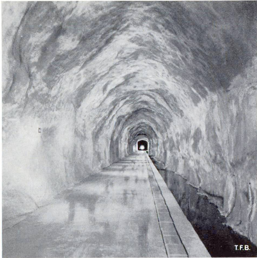
Fig. 4 Galerie à écoulement libre avec revêtement en béton projeté de l'entreprise de la Maggia. (Photo F. M. M.)
