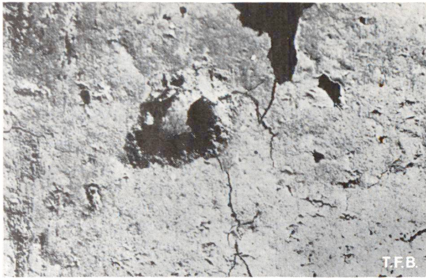
Fig. 1 Fissures de retrait et décollement d'un mortier trop gras
