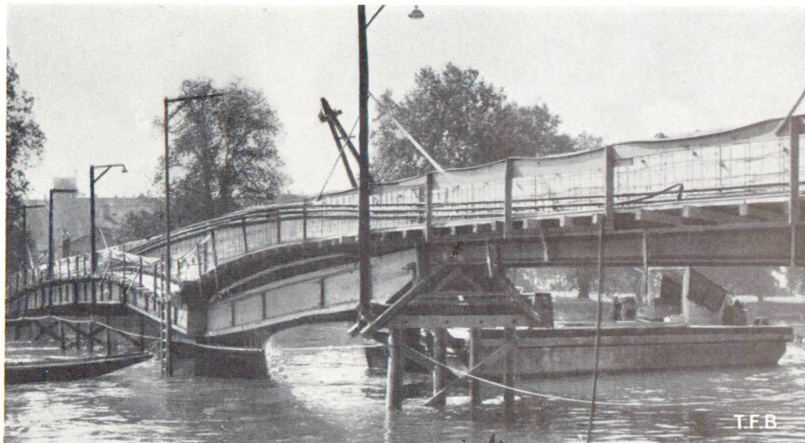
Fig. 14 Passerelle sur l'Aar, Aarau. Etat de la construction avant la pose du coffrage extérieur. On aperçoit les 3 câbles de 80 t., relevés sur la pile en rivière. Echafaudage avec profils en acier et poutres en bois collé
