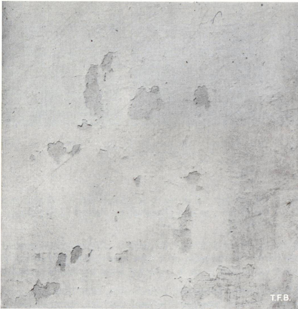
Fig. 3 Ecaillage d'une peinture de façade dû à une adjonction inappropriée au mortier
