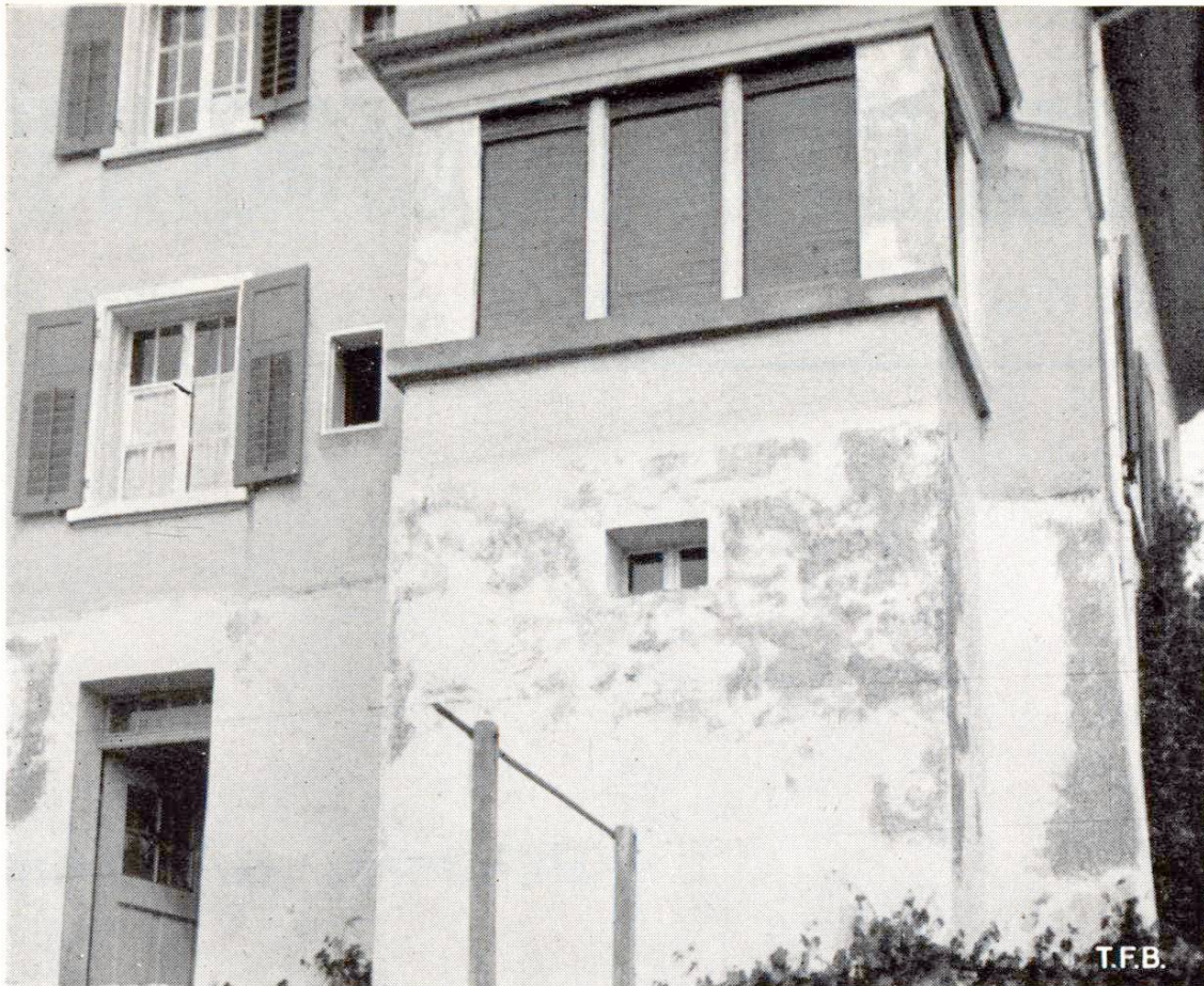
Fig. 1 Ecaillage d'une peinture à la chaux sur une fondation en béton et sur des enduits exposés
