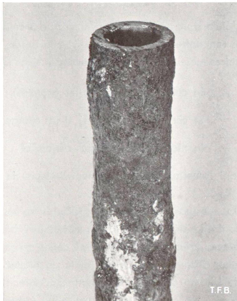
Fig. 3 Corrosion d'un tuyau en plomb provoquée par le mortier avoisinant. L'attaque progressive ressort des différentes colorations des couches d'oxyde (oxydes de plomb jaunes et rouges)
