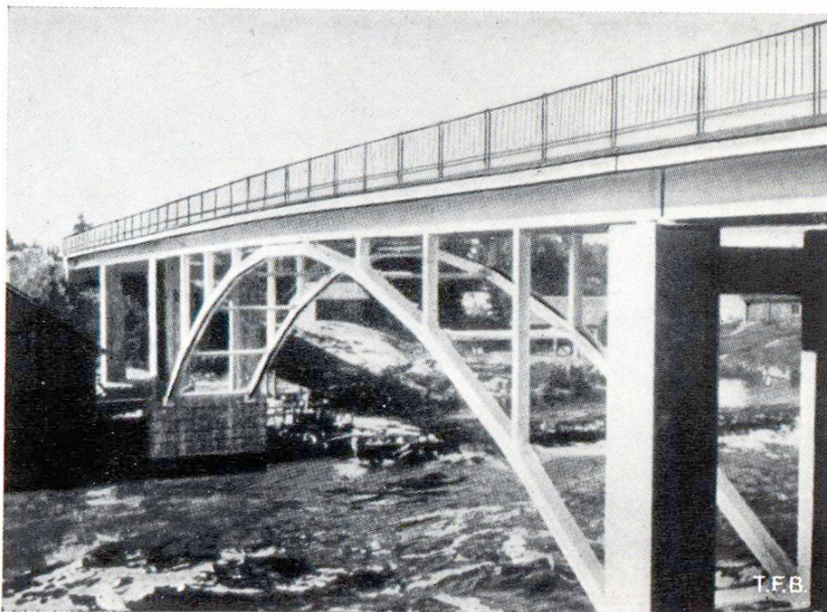
Fig. 4 Pont de Koskenniska sur la rivière Kymi, Finlande. Arc brisé raidi par le tablier. Portée 40 m (voir bibl.)
