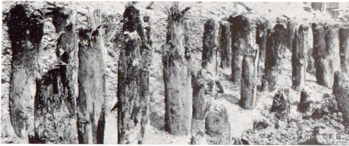
Fig. 5 Têtes de pieux en bois pourries. Décomposition des parties situées au-dessus du niveau de la nappe phréatique (Phot. Raymond, NYC)
