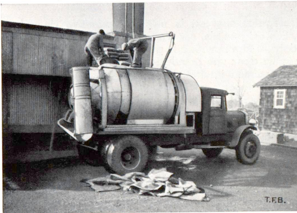
Fig. 6 Camion-malaxeur de 3m 3 . Le ciment est ajouté après l'introduction du sable et du gravier, puis l'eau est versée dans le malaxeur obturé. Celui-ci est actionné peu avant d'atteindre le chantier
