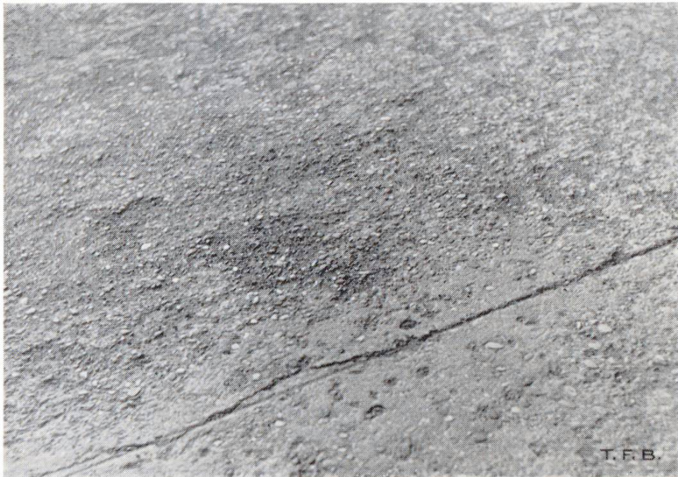
Fig. 6 Usure exagérée d'un revêtement en ciment par suite de l'emploi de mortier trop dilué pour la couche ribée
