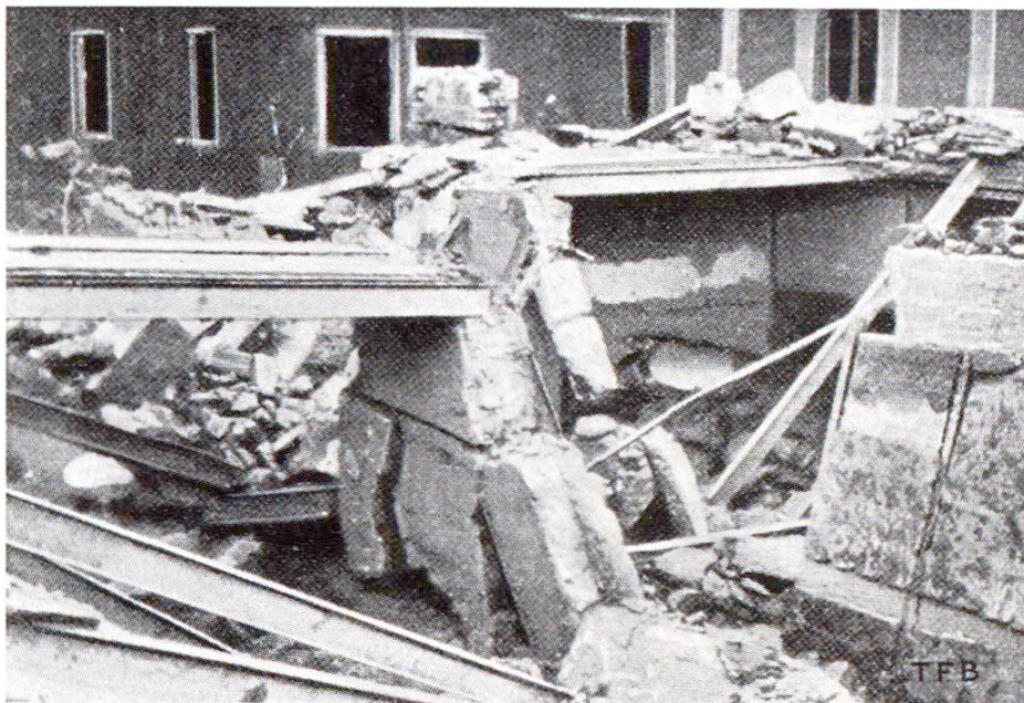
Fig. 6. Vue d'une partie du bâtiment de fabrique détruit au moyen de mines. (d'après E. Stettler, voir bibli.).
