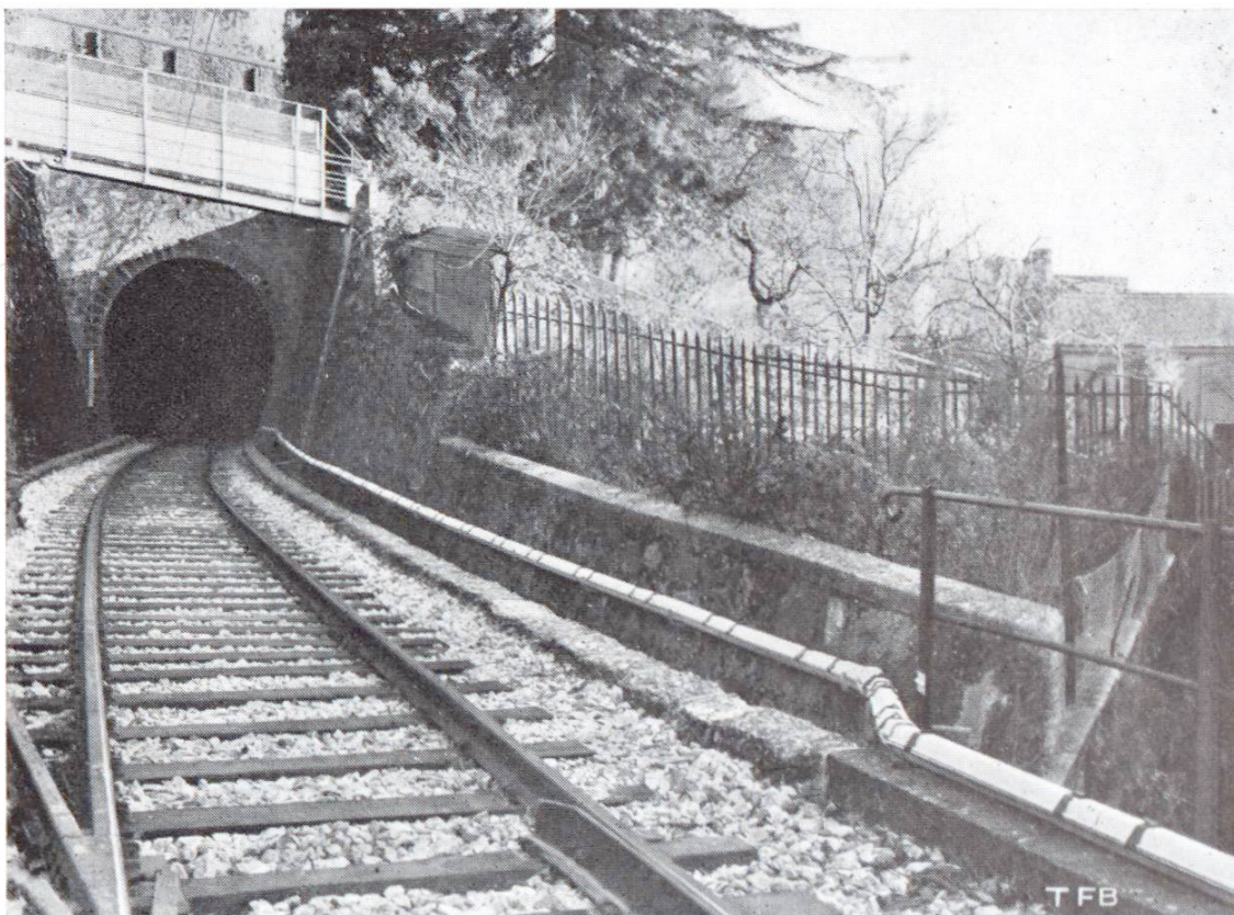
Fig. 3 Zorès en Eternit comme protection de câbles le long d'une voie de chemin de fer. L'Eternit est insensible aux courants vagabonds.
