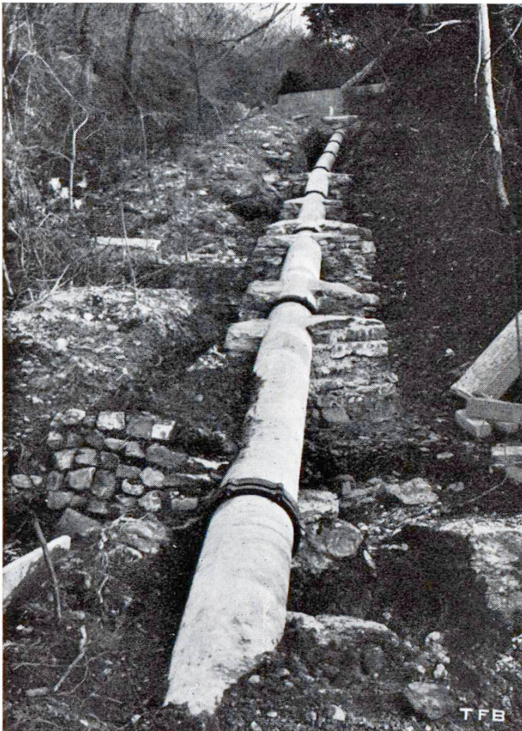
Fig. 2 Conduite de turbine en tuyaux Eternit de 400 mm \varnothing et pression d'essai de 18 atm.
