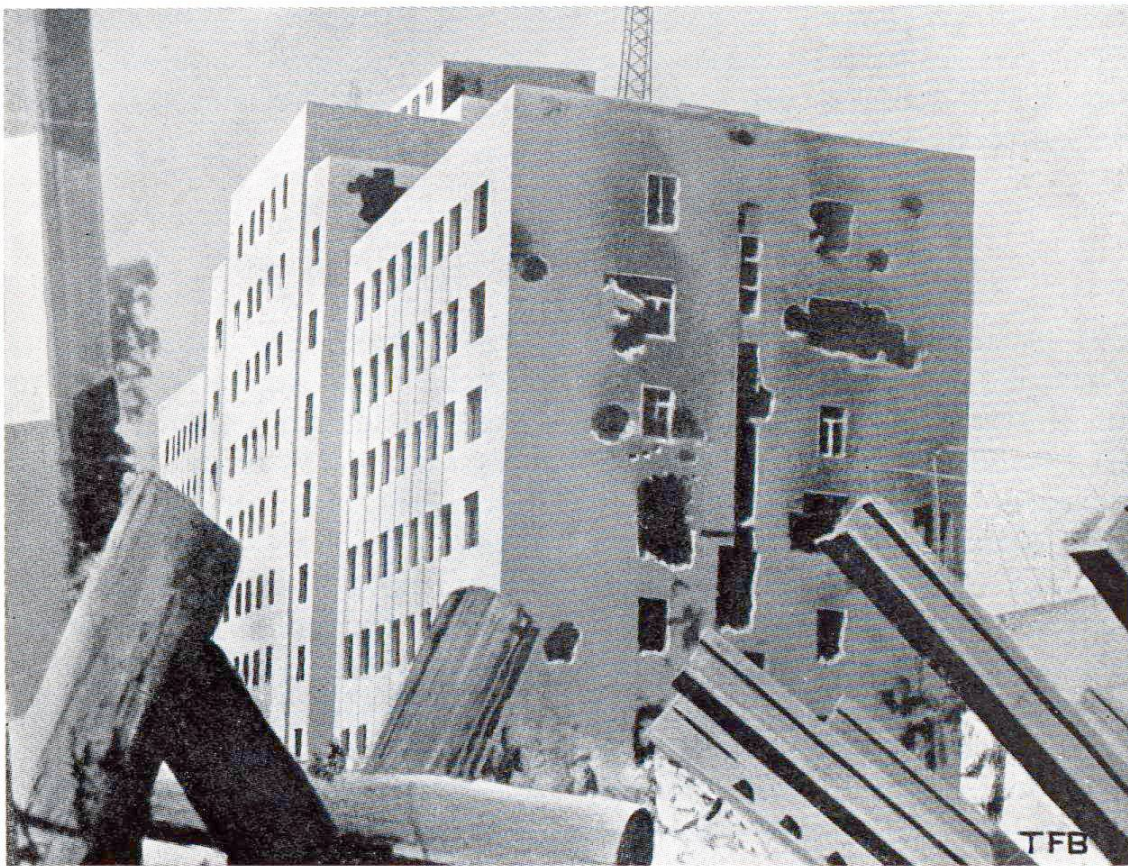
Fig. 1 Bâtiment d'administration de la gare du Nord de Shanghai après le bombardement.
