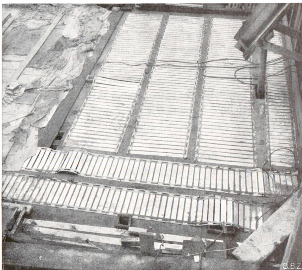
Fig. 2 Tapis d'électrodes sur une dalle en béton armé (bâtiment de commerce à Zurich).
