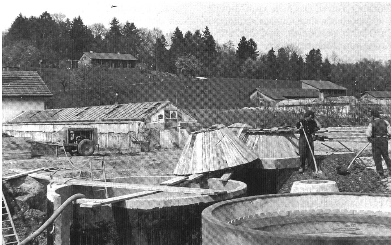
Die hauseigene Kläranlage beim Erlenhof, hier noch im Bau (1953), entlastete den Dorfbach von grossen Mengen Schmutzwassers. (Bild: Archäologie und Museen Baselland, Liestal)
