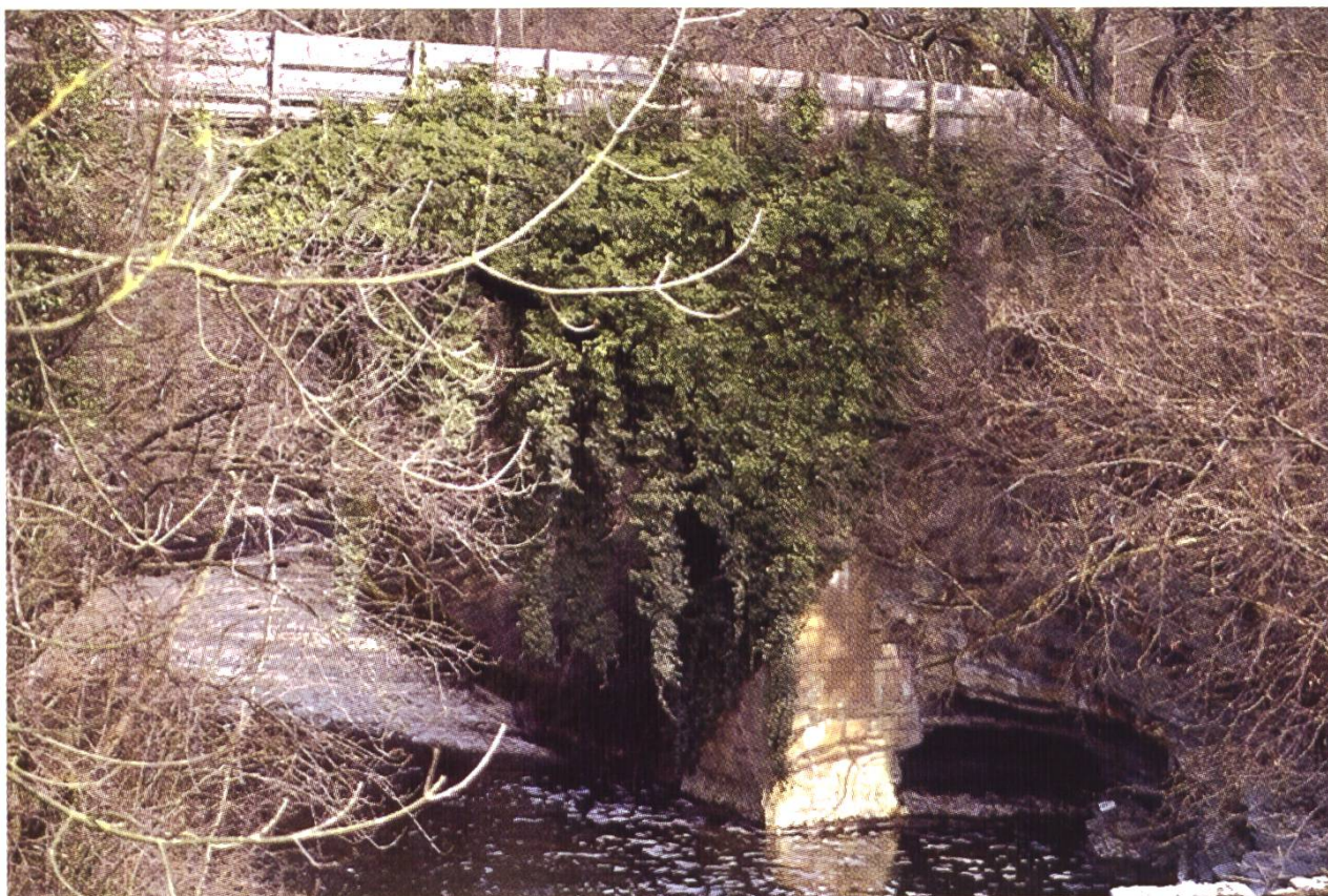
Abb. 14: Die Brücke präsentiert sich nicht mehr als das elegante Bauwerk, das es einst war. (Foto ViaStoria, Eneas Domeniconi, März 2003)
