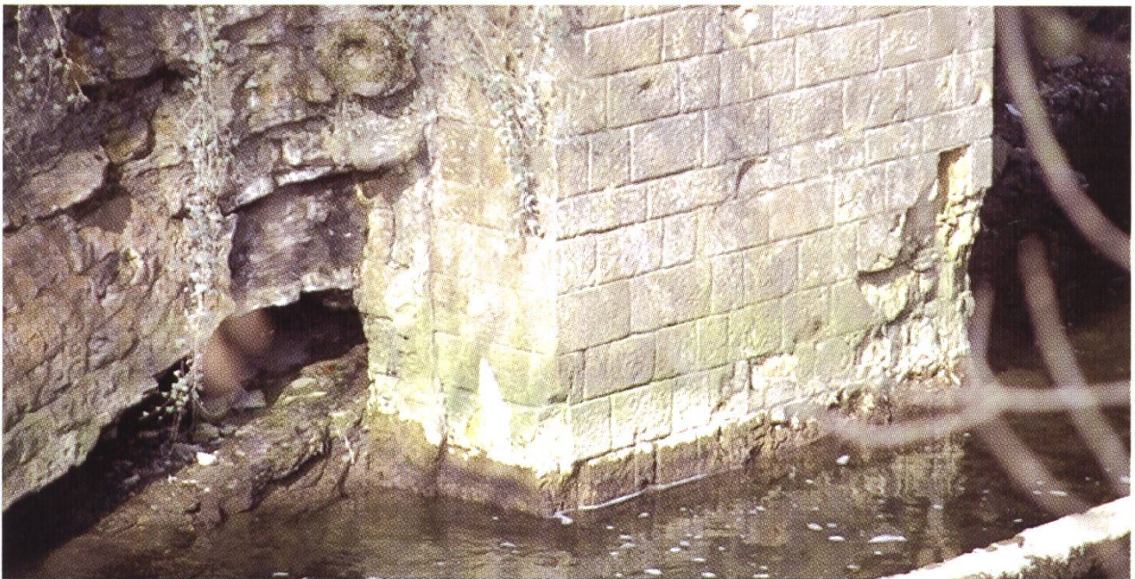
Abb. 13: Die Steinenbrücke ist renovationsbedürftig wie diese Beschädigungen am westlichen Widerlager zeigen. Im Bild links nagen auch durch Wasser verursachte Auskolkungen für einen raschen Zerfall. (Foto ViaStoria, Eneas Domeniconi, März 2003)
