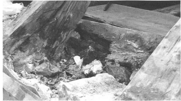
Abb. 1: Laufen, St. Katharinenkirche. Hausschwammbefall auf der Nordseite des Dachstuhls.
