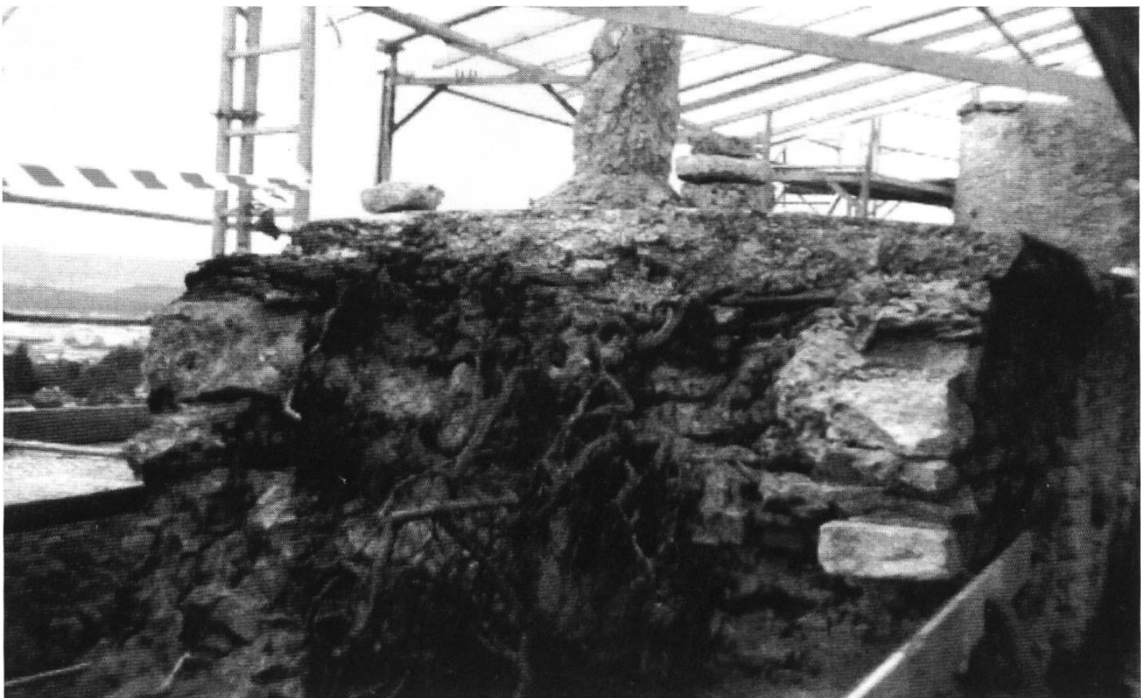
Abb. 4: Arlesheim, Schloss Birseck. Südmauer, Querschnitt Mauerkrone. Die Durchwachsung sowie das ältere Abflusssystem aus Ziegeln sind gut erkennbar.
