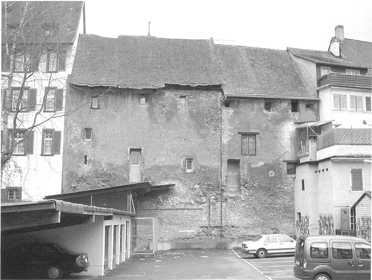
Abbildung 3: Zustand des Stadtmauerabschnitts vor Beginn der Sanierung.
