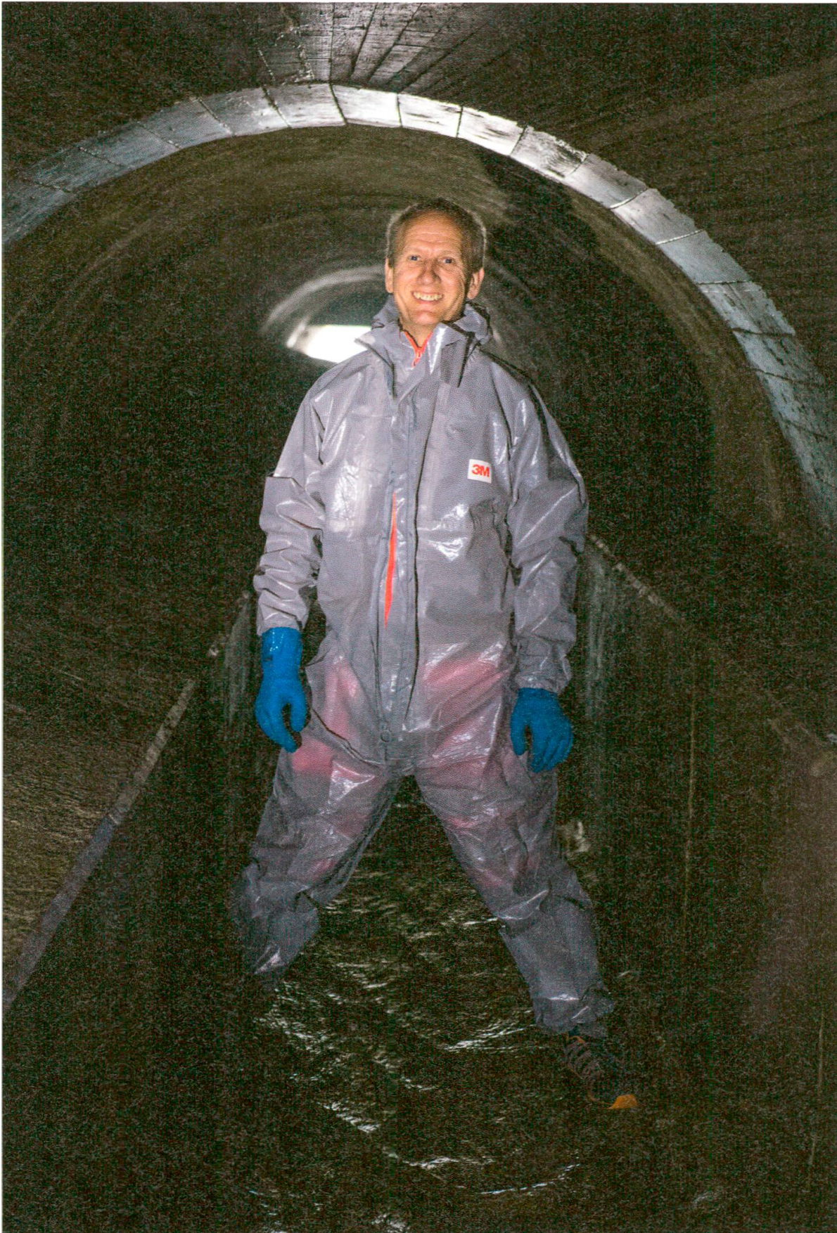
Markus Muff an seinem unterirdischen Arbeitsplatz – unter ihm der Stadtbach, der direkt in die Limmat fließt. Bild: Alex Spichale, Baden.
