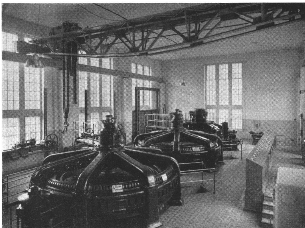
Innenansicht des Kraftwerkes Aue (Ausbau 1925)
