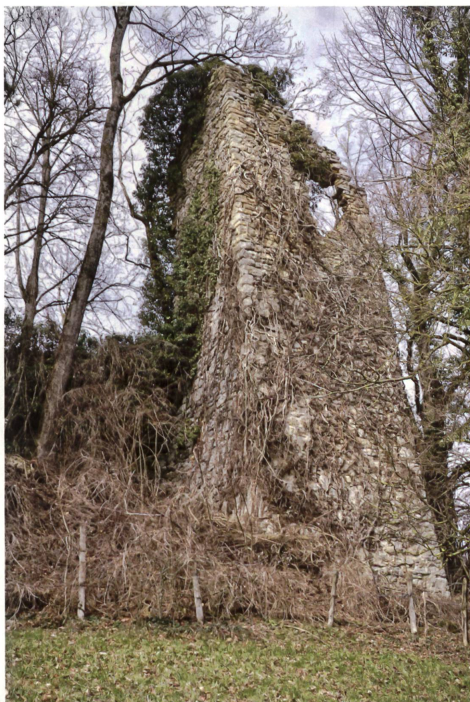
← Fig. 19 Montagny-près-Yverdon Château de Montagny-Le-Corbe. Vue de la tour pentagonale, avec la fenêtre / archère sur sa façade sud-est. © G. Nogara
