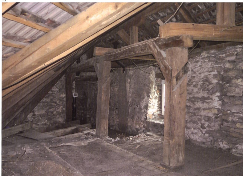
Abb. 13 Olten, Marktgasse 27. Gedeck- te Wehrgangkonstruktion von 1690 über dem Hexenturm. Links im Hintergrund ist die westliche Giebelwand des Spittels zu erkennen. Zustand vor dem Umbau 2020.
