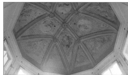
Abb. 5 Das dekorativ ausgemalte Gewölbe im Erker nach der Restaurierung (vgl. auch Farbabbildung Seite 106).
