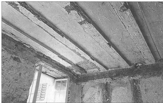
Abb. 1 Die vergipste Balkendecke nach der Demontage von zwei jüngeren darunter gehängten Gipsdecken, Fundzustand.
