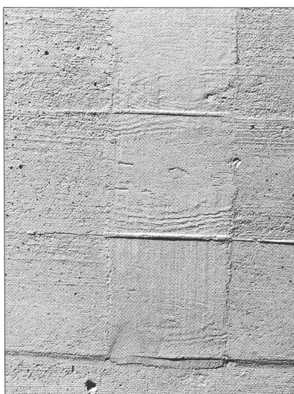
Abb. 4 Ostfassade, reprofilierte Partie.
