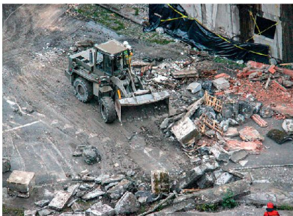
Trümmer versperren die Zufahrten.
