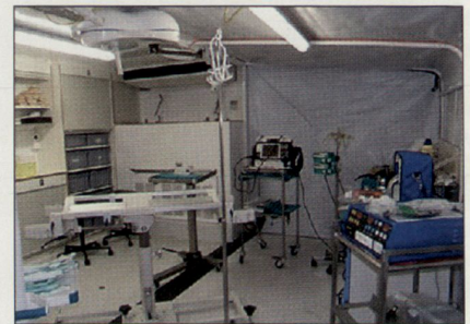
Installierter Sanitäts-Container (inkl. Generator, Wasseranschlüssen und Klimaanlage).
