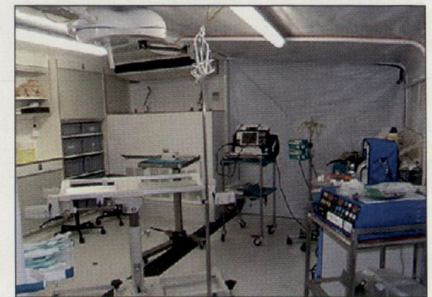
Installierter Sanitäts-Container (inkl. Generator, Wasseranschlüssen und Klimaanlage).
