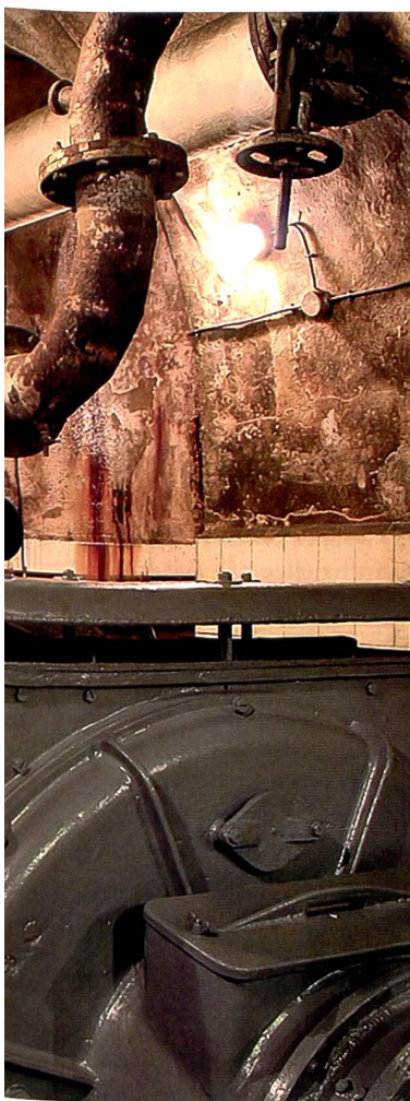
Abbildung unten: Artilleriewerk Michelsberg, Kraftwerk.
