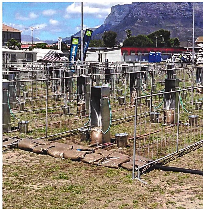
Wasserabgabestelle in Kapstadt.
