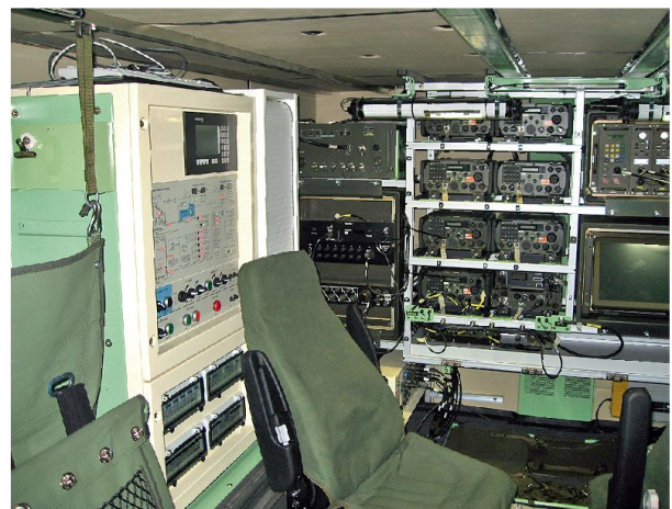
Innenansicht eines Radio Access Point Panzers (RAP Pz): Integration von Telekommunikationsausrüstung auf engstem Raum.
