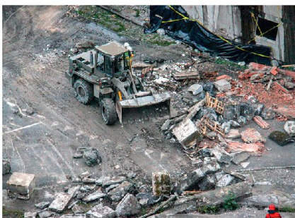
Trümmer versperren die Zufahrten.
