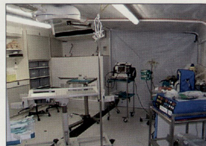
Installierter Sanitäts-Container (inkl. Generator, Wasseranschlüssen und Klimaanlage).
