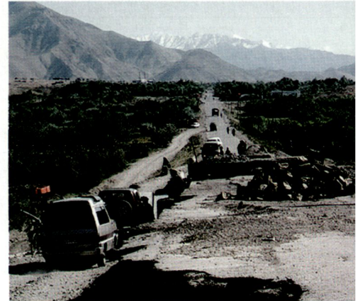
Zerstörte Strassen in der Shomali-Ebene.
